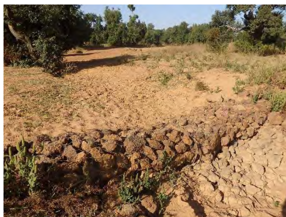
侵食の深い場所に設置された蛇籠（ガビオン）。 （タンポンガ村）
