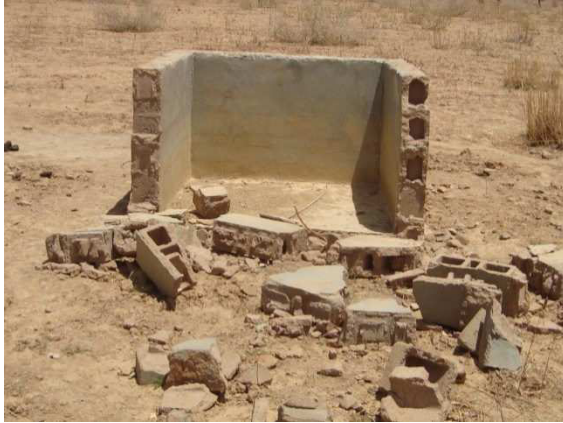
水やり用の湖水を溜めるために建設した貯水槽が、破壊されてしまいました。
