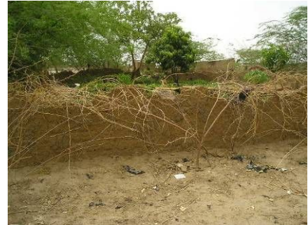
降雨により崩れ、低くなった塀を乗り越えてくる家畜を防ぐため、棘のある枝で補強している。
