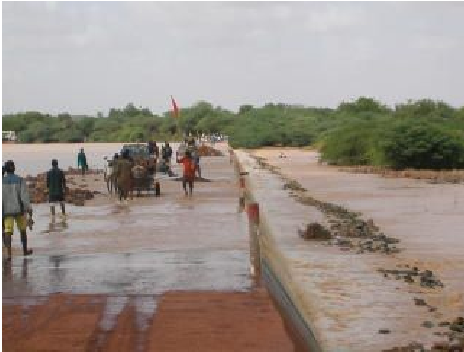
ヤルゴに架かっている橋兼用ダムの2ヶ所が崩れ、現在車の通行ができない。 (ブルキナファソ、6月)
